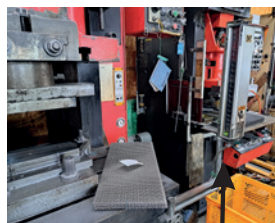
赤外線装置 (切断機の右側手前)
